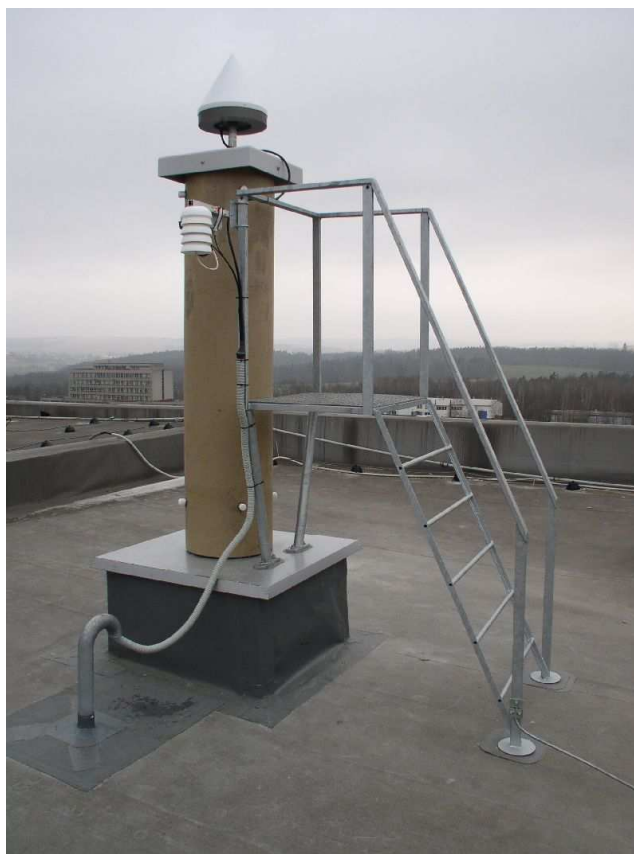
Stanice DGPS na střeše budovy rektorátu VŠB-TU Ostrava
